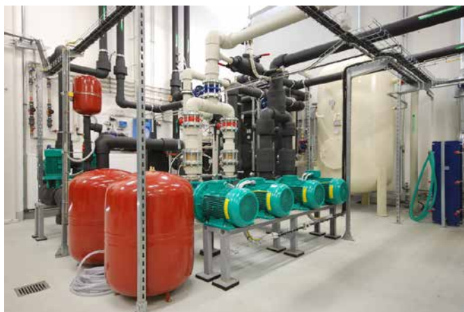
Obr. 7 Strojovna chlazení – technologie free-cooling
