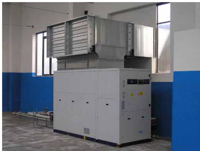
Obr. 6 Vnitřní instalace kompresorové jednotky M.T.A. s využitím odpadního tepla
